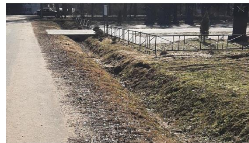
Отсутствие вдоль проезжей части пешеходных тропинок
